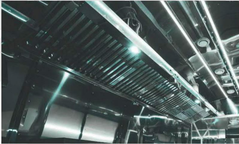
Lüftung und Heizung
